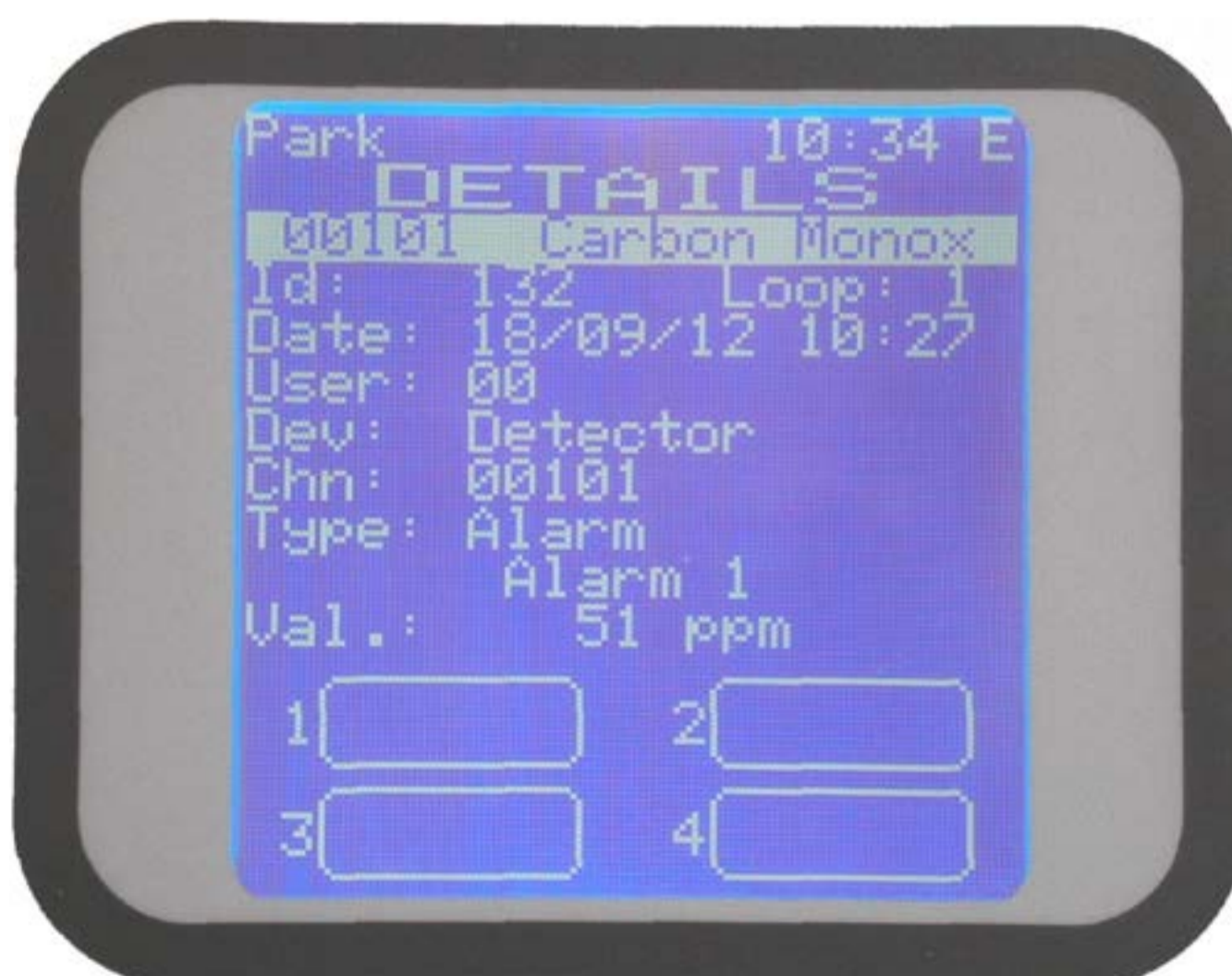
Figura 21 Dettagli evento di Allarme 1
