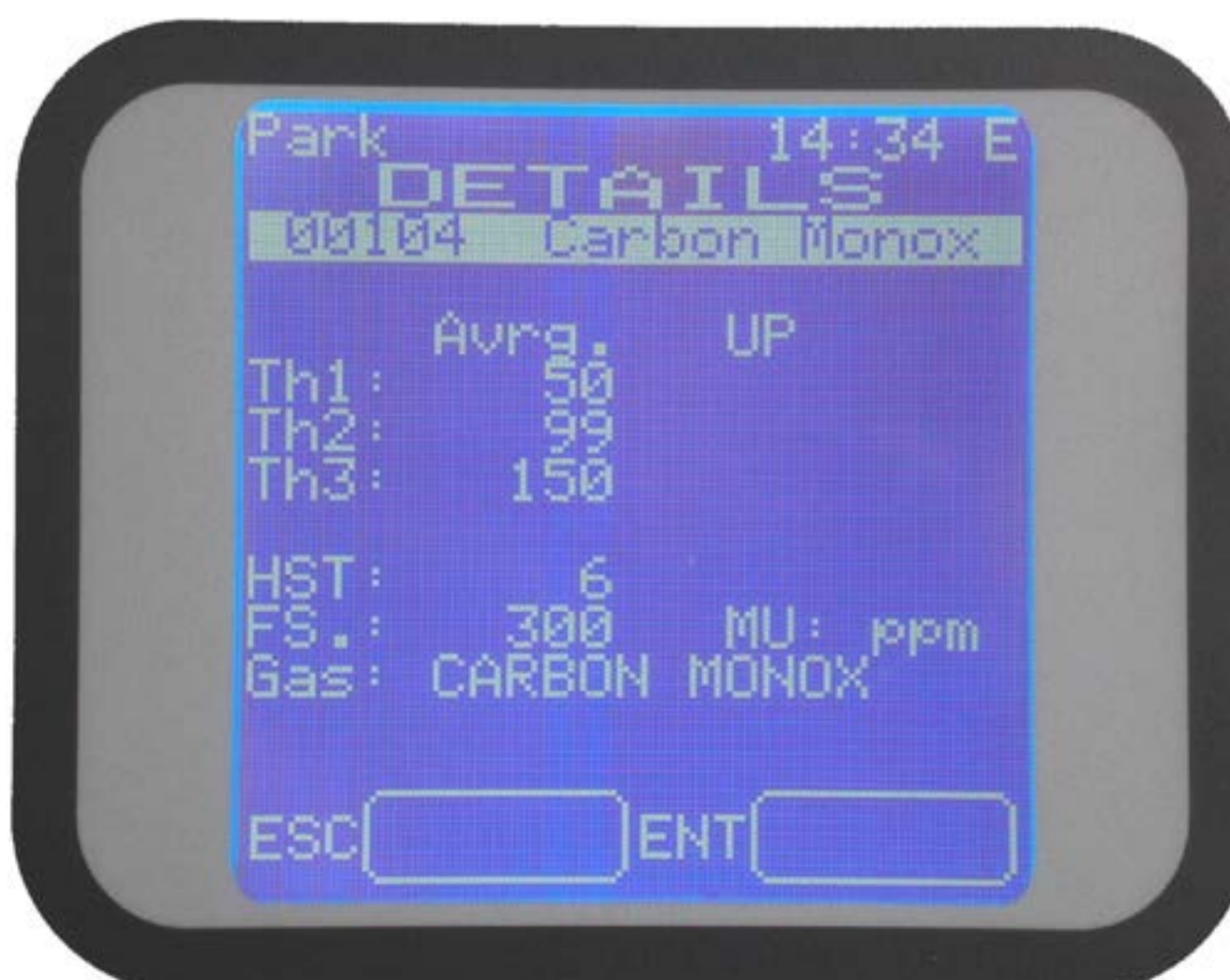
Figura 42 Dettagli configurazione rilevatore gas
